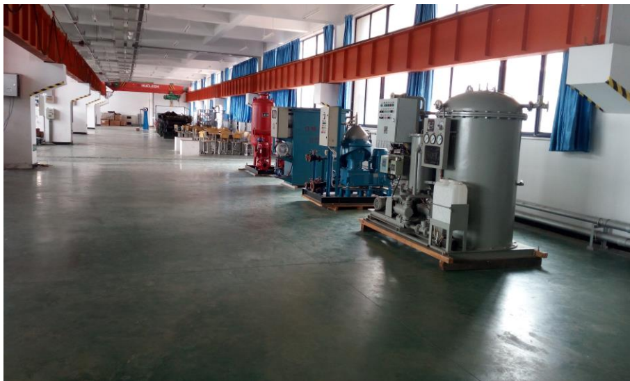
图 2 船舶辅机安装与维修实训区
